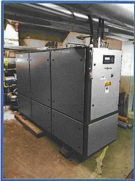
BHKW und Heizkessel in Haus E
